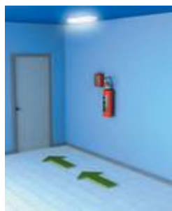
Près de chaque extincteur et point d'appel de secours.
