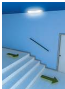
Près des escaliers afin que chaque marche reçoive un éclairage direct.
